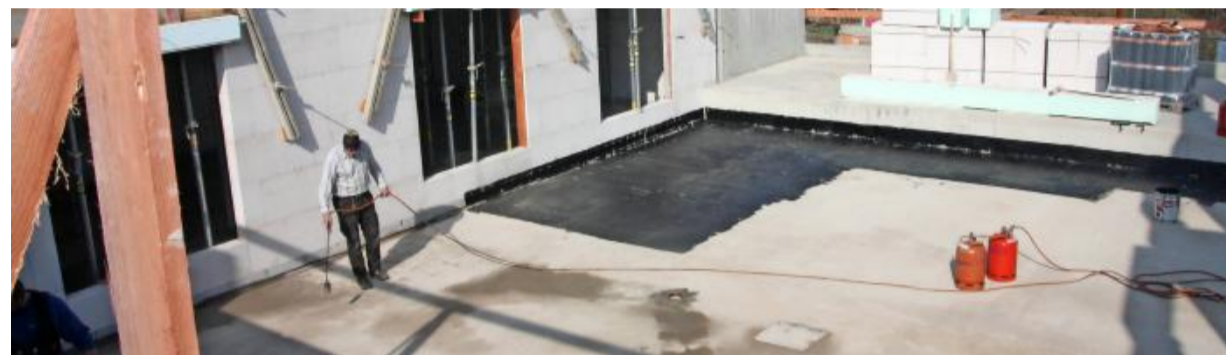
Markus Krawczyk schweißt mit dem Flächenbrenner die Dampfsperre auf den Boden. Sobald der Rohbau so weit fertig ist, wird mit dem Innenausbau des Lehrensteinsfelder Heims begonnen.
